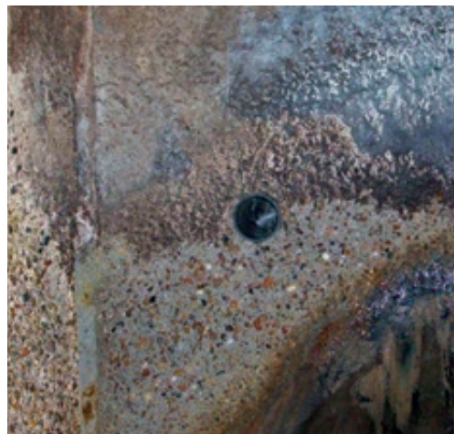
Abb. 9: Von Biokorrosion angegriffene Stahlbetonoberfläche mit verschiedenen Korrosionsraten
